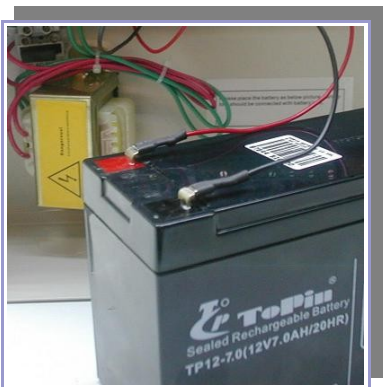
Imagen N°4 : Conexión de batería respaldo
